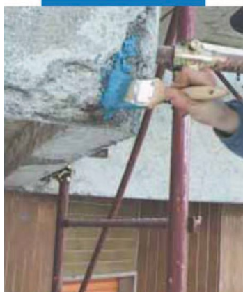
Applicazione a pennello di Mapefer 1K sui ferri di armatura di un balcone in calcestruzzo armato
